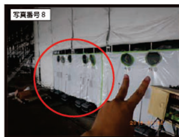
写真番号8: 負圧除じん機排出口1~7 負圧除じん機は、指で示している1と2のみ稼働し、 ○で囲んだ3~7は稼働していない。 稼働していない負圧除じん機3~7の排出口内を測定している。
